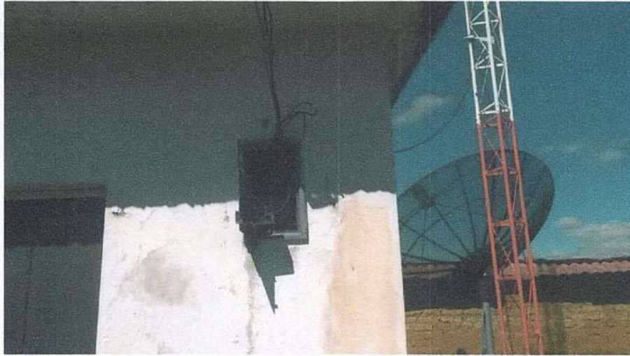
Ilustración 1. Podemos verificar que la caseta de comunicaciones necesita Mantenimiento en San Jose de Salo Bajo.
