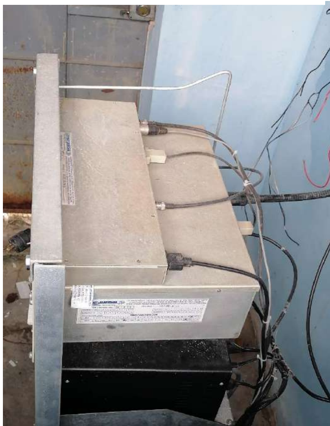
Imagen 10. Cablería de conexión de equipos requieren etiquetado y reordenamiento.
