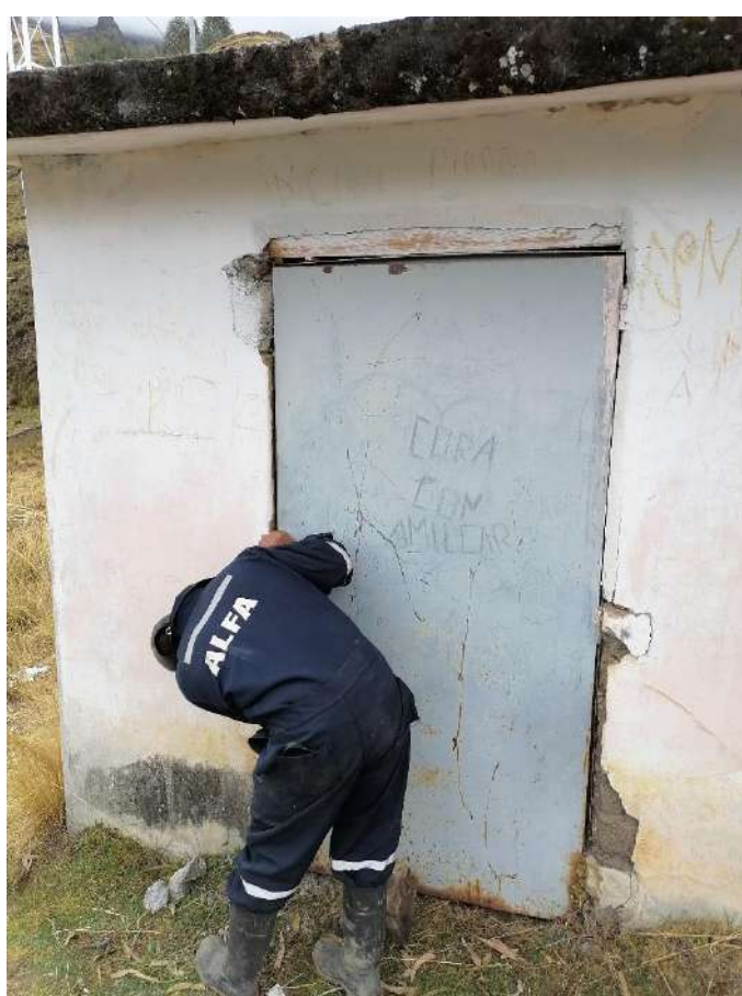
Imagen 8. Puerta metálica de caseta presenta zonas oxidadas.
