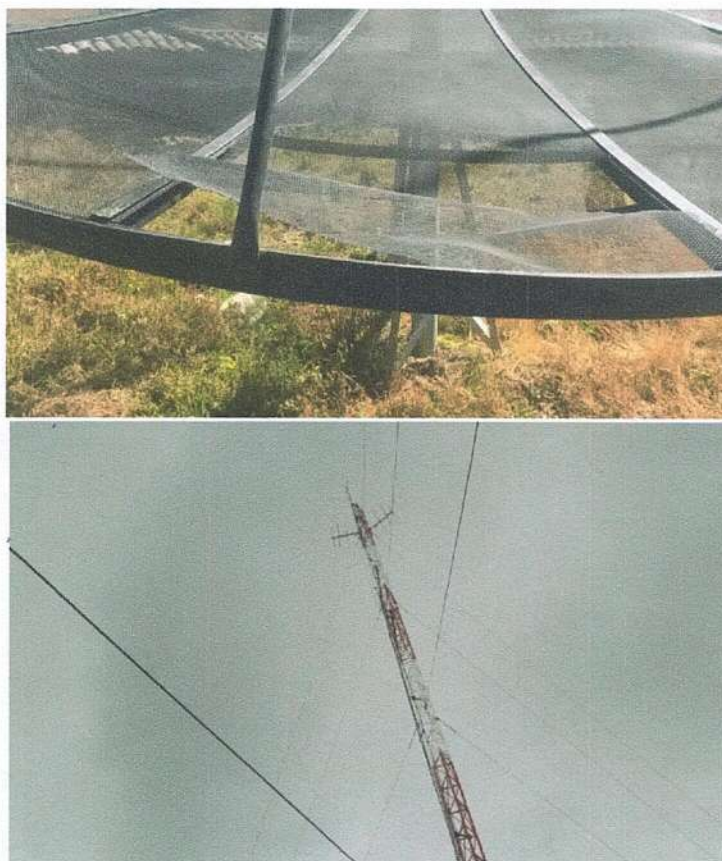
Ilustración 5,6. Sistema radiante necesita mantenimiento preventivo y correctivo Se tiene que hacer Mantenimiento de antena parabólica, cambio de pétalos y pintura de soportes. También se puede verificar que no hay cerco perimétrico para protección de equipos.
