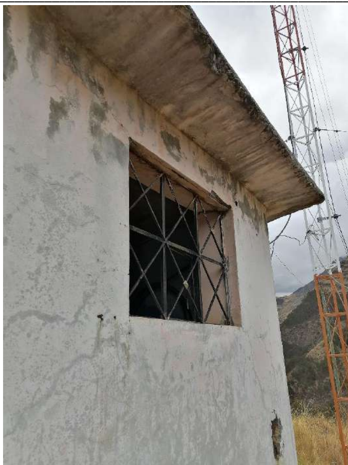
Imagen 7. Ventana de caseta presenta marco metálico sin vidrio y zonas oxidadas.
