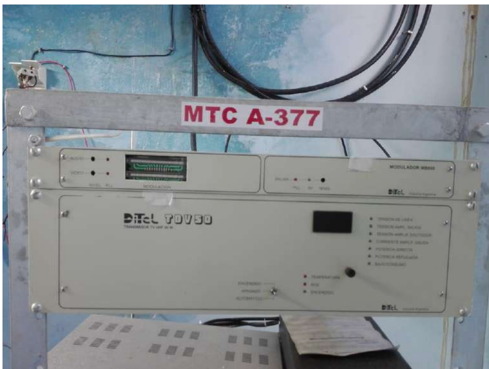
Imagen 14. Transmisor de TV y modulador completamente siniestrados e inoperativos por descarga eléctrica producto de truenos en la zona.
