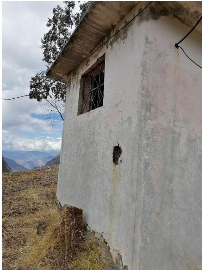
Imagen 6. Zona exterior de caseta está despintada y con partes por resanar con Tarrajeo.
