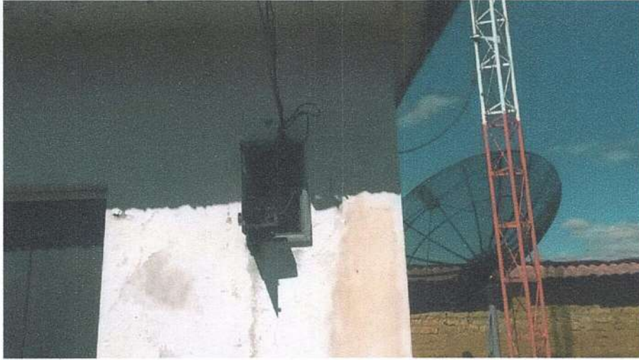
Ilustración 1. Podemos verificar que la caseta de comunicaciones necesita Mantenimiento en San Jose de Salo Bajo.
