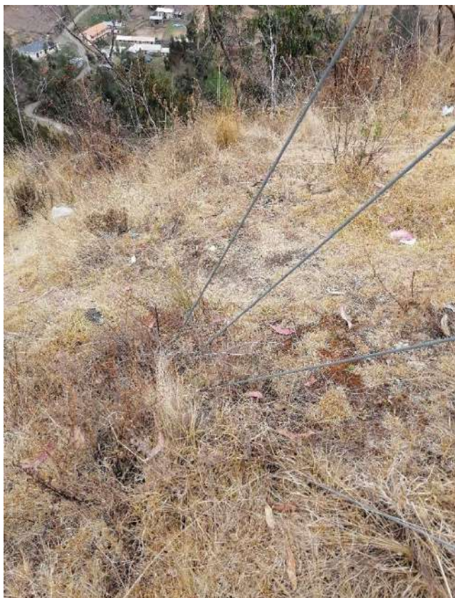
Imagen 2. Templadores, grapas y grilletes requieren mantenimiento preventivo.
