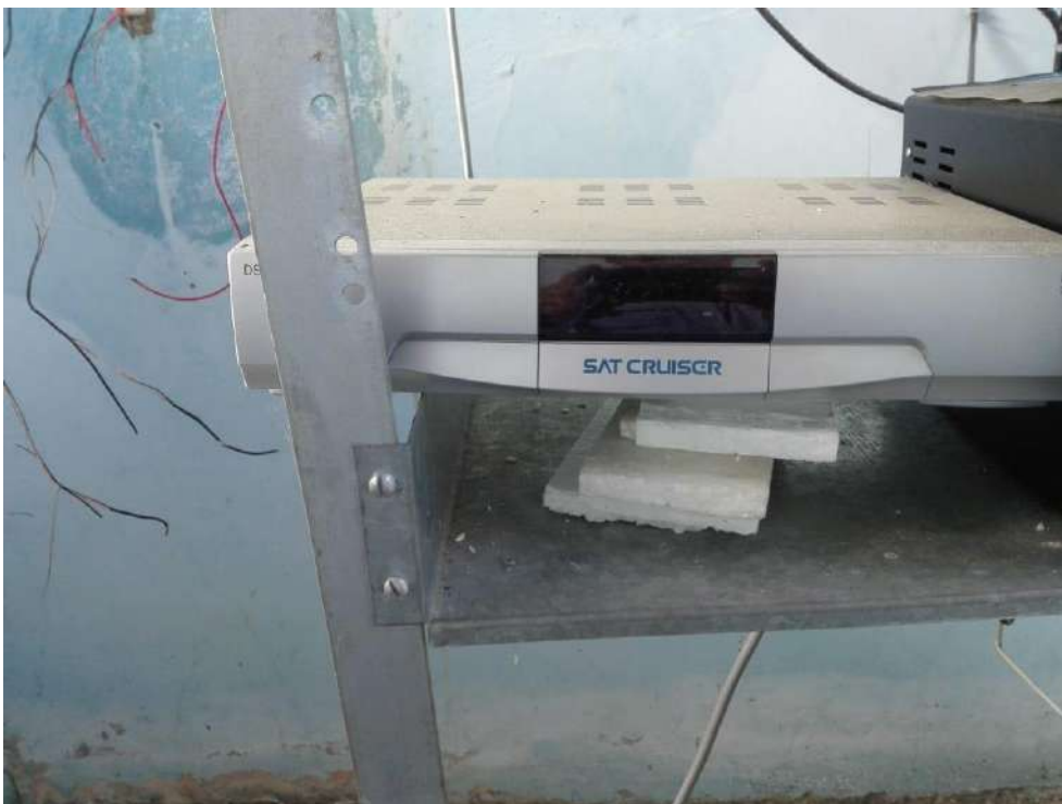
Imagen 13. Receptor satelital siniestrado e inoperativo por descarga eléctrica producto de truenos en la zona
