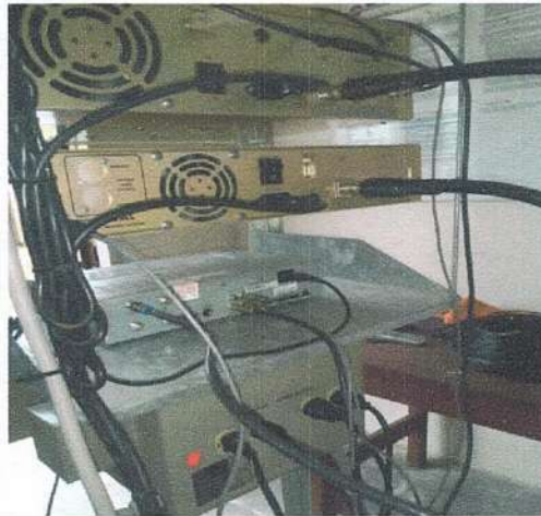
Ilustración 3. El rack de comunicaciones se debe dar para un mejor aterramiento a los equipos se tendrá que ofertar una tabla de aterramiento independiente para el rack de comunicaciones TBG
