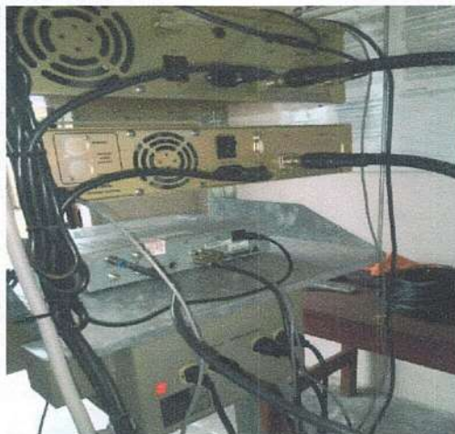
Ilustración 4. El rack de comunicaciones se debe dar para un mejor aterramiento a los equipos se tendrá que ofertar una tabla de aterramiento independiente para el rack de comunicaciones TBG
