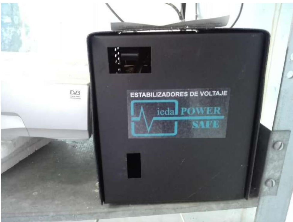
Imagen 12. Estabilizador de tensión siniestrado por descarga eléctrica producto de truenos en la zona.
