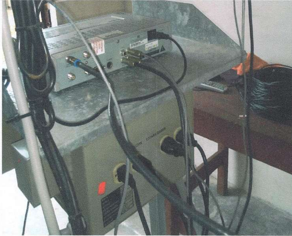
Ilustración 7. Equipos de comunicaciones se están funcionando pero se necesita hacer un mantenimiento preventivo y correctivo.
