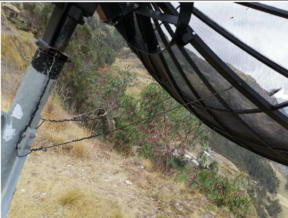
Imagen 11. Pernería de antena parabólica en mal estado, se requiere cambio e instalación de nueva pernería.
