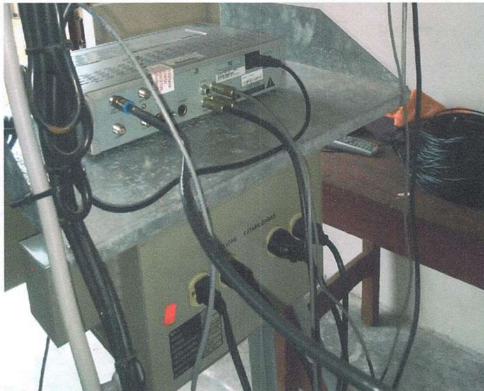
Ilustración 7. Equipos de comunicaciones se están funcionando pero se necesita hacer un mantenimiento preventivo y correctivo.
