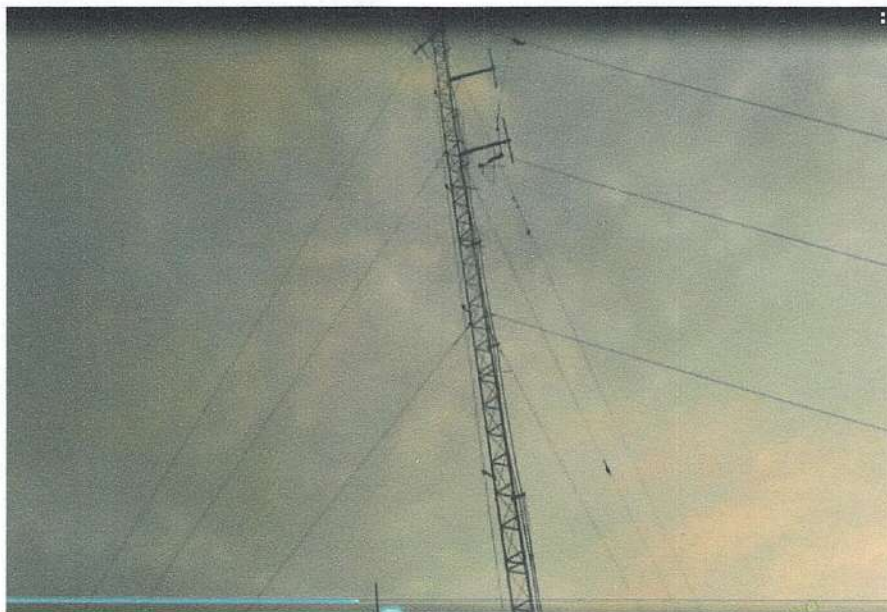
Ilustración 5. Sistema radiante necesita mantenimiento preventivo
