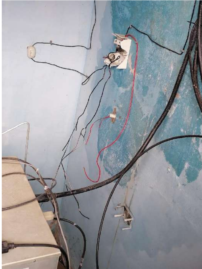
Imagen 9. Instalación eléctrica de caseta en pésimo estado y con cables expuestos.
