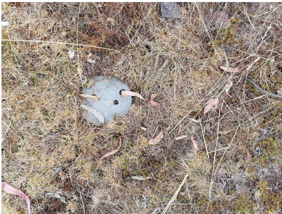
Imagen 3. Pozo a tierra actual requiere reinstalación e independizarlo con otro pozo a tierra para sistema pararrayos.
