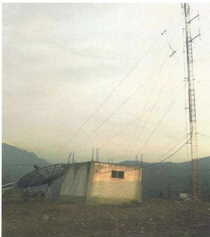
Ilustración 6. Caseta requiere mantenimiento.
